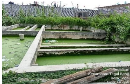
Gambar 7. Kondisi IPAL Terpadu di PPP Tegalsari
