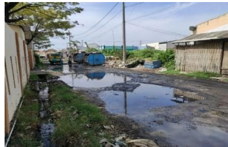
Gambar 8. Kondisi jalan di depan UPI dan TPS Tegalsari
